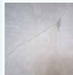
このようなひび割れが数本
