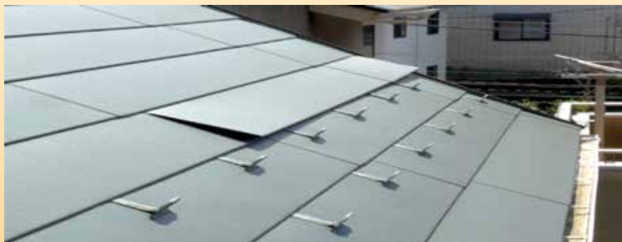
↑横断ルーフは風で飛ばされそうになっているところが多いです
